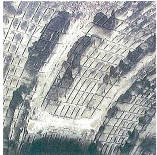
損傷状況写真
