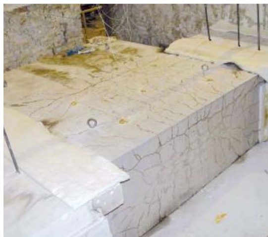
写真 2.1 供試体のひび割れ状況
