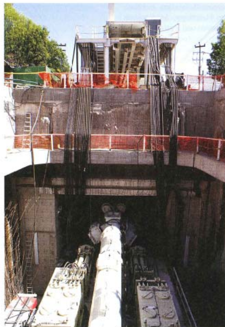
4 Der Vortrieb begann vom Schacht aus mit Verbindung zu den Nachläufern an der Erdoberfläche
