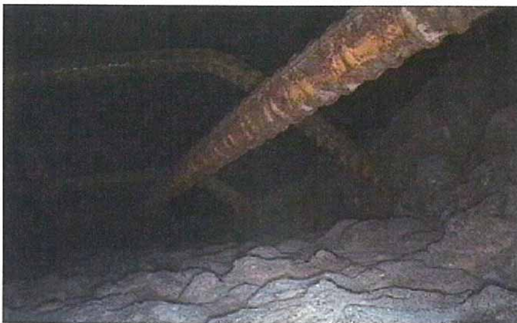
1 Freiliegende Bewehrung im Firstbereich einer Tunnelinnenschale
