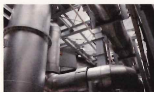
プラント配管
