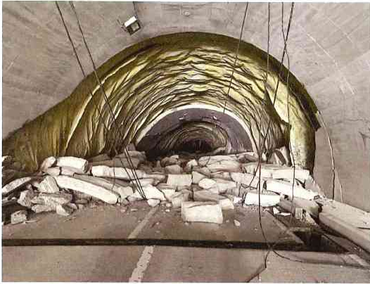
写真-8 大谷トンネルの被災状況(国土交通省提供)
