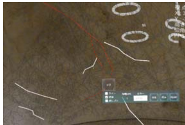
ひび割れ朱書き機能
