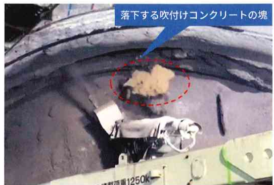
写真-6 吹付けコンクリートの落下
