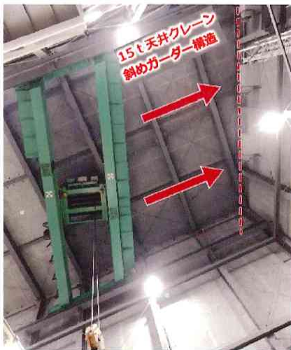
写真-8 天井クレーン(15t)稼働状況
