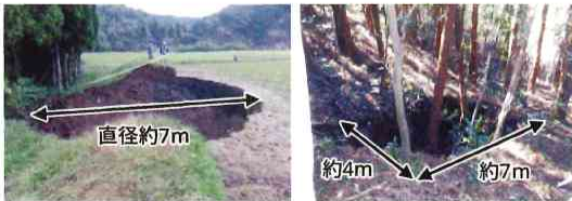
写真-1 沿線トンネルの地表陥没事例
