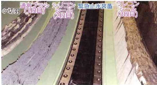
写真-3 緊急止水装置
