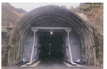
写真-4 導坑防音扉(風門)
